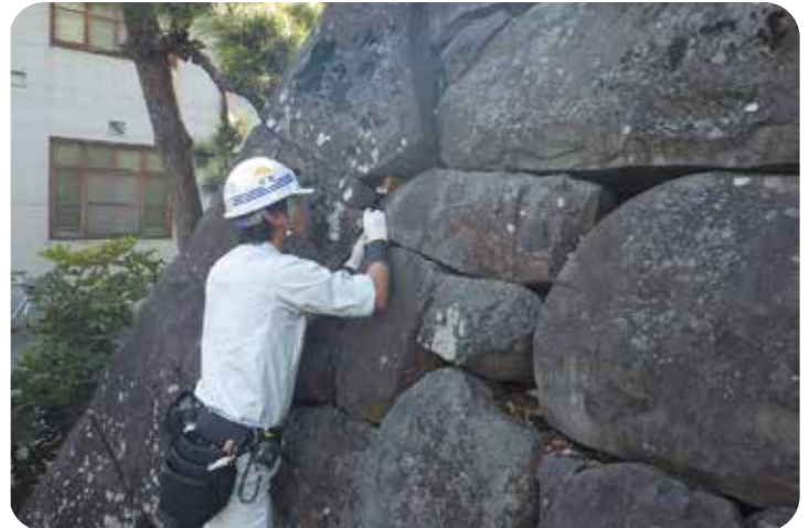
観測用ゲージの設置状況
