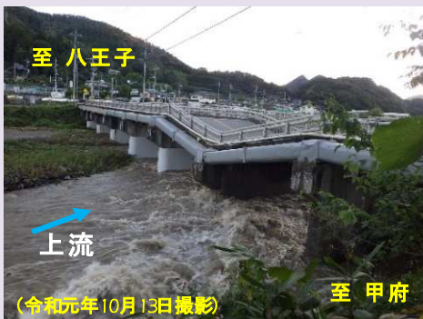
【法雲寺橋の被災状況】
