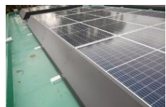
太陽光発電設備
