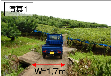
狭小な農道は見通しも悪く農作業車両の安全な通行に支障がある。
