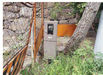
受水槽電源盤
