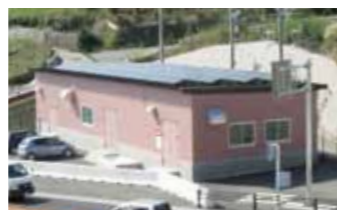
万力八幡トンネル 太陽光発電システム
