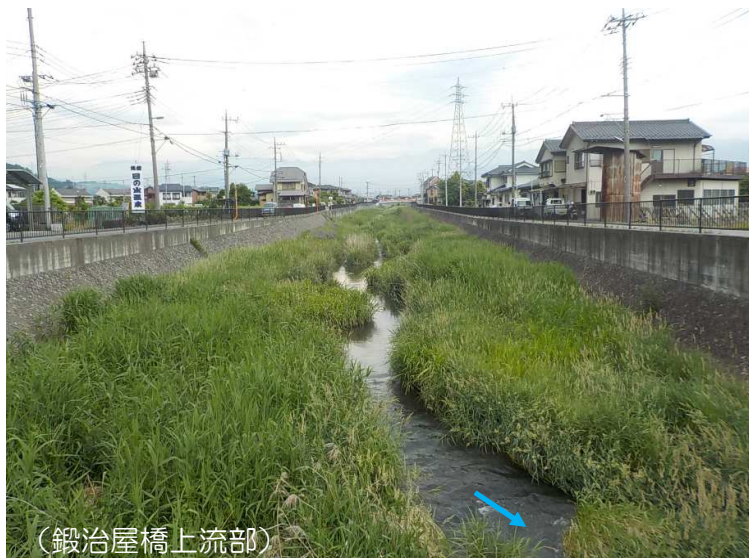
現況 (濤筋の形成状況)
