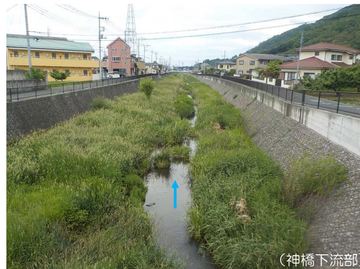
現況 (濤筋の形成状況)
