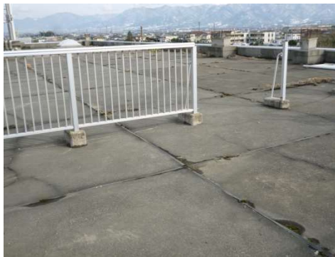
屋上防水シートの破損による雨漏り
