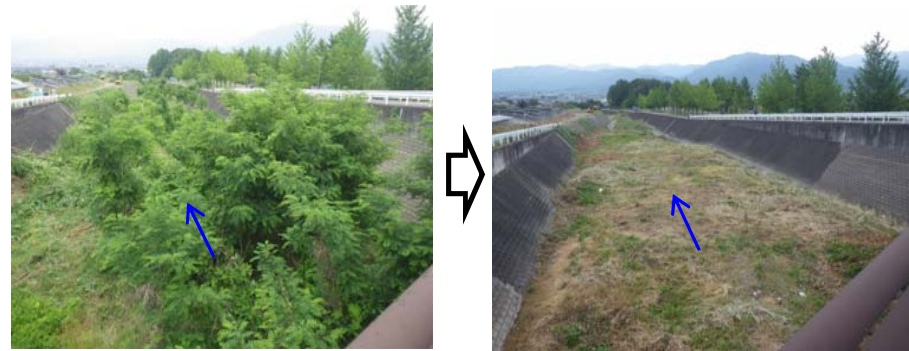
坪川 伐木 L=440m A=5,800m 2 (写真は南アルプス市川上地内 北落合橋下流)
