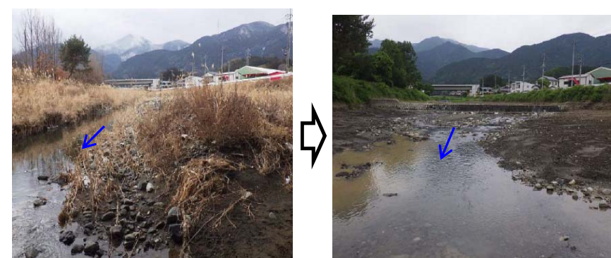
船山川 浚渫 L=340m V=8,400m 3 (写真は南部町南部地内 新船山川橋上流)
