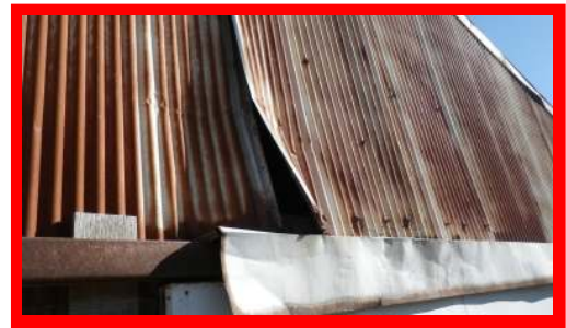
鶏舎トタン壁のめくれ
