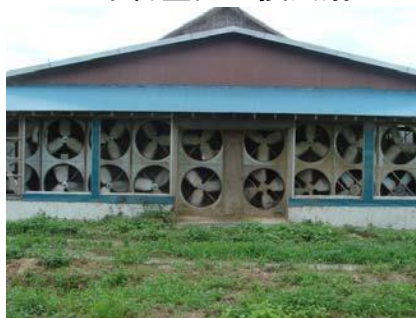
牛舎壁面の換気扇
