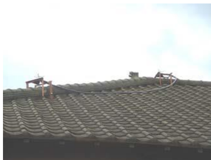
牛舎屋根に設置したスプリンクラー
