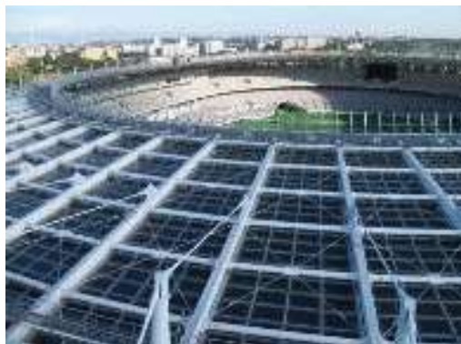
図表 26 味の素スタジアムの屋根部分に設置されている太陽光パネル
