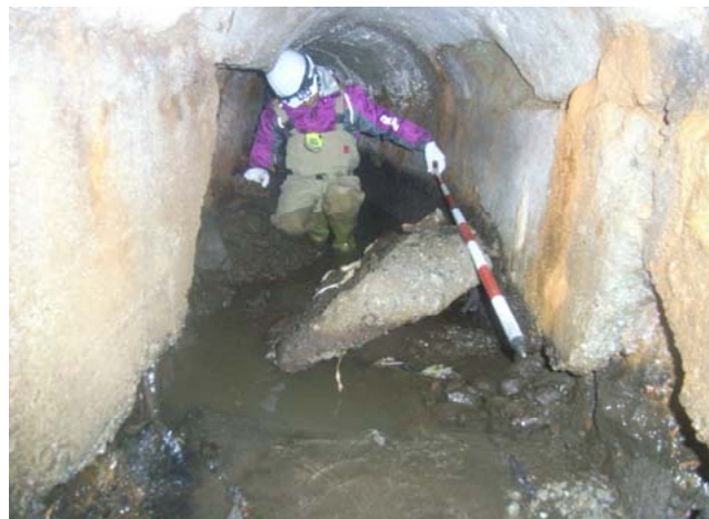
④ トンネルの崩壊状況
