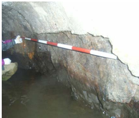
③ トンネルの崩壊状況
