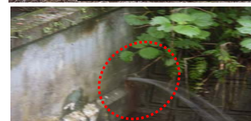
⑥ 老朽化し漏水している「水路橋」
