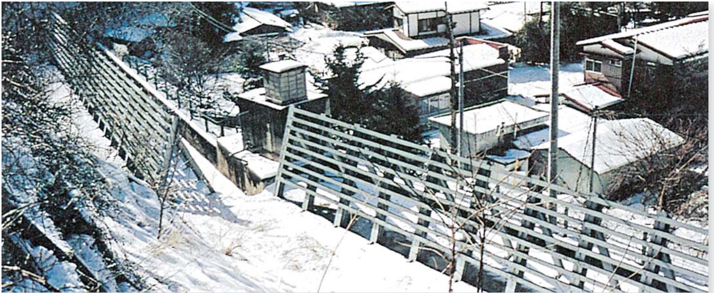
■雪崩防護柵（南巨摩郡早川町白沢）
