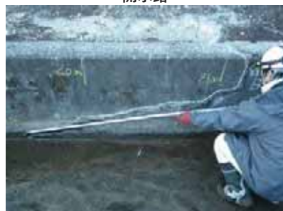
ひび割れ発生状況
