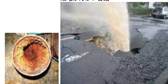
老朽化した管路の破裂
