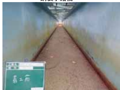
錆による鋼材の腐食状況
