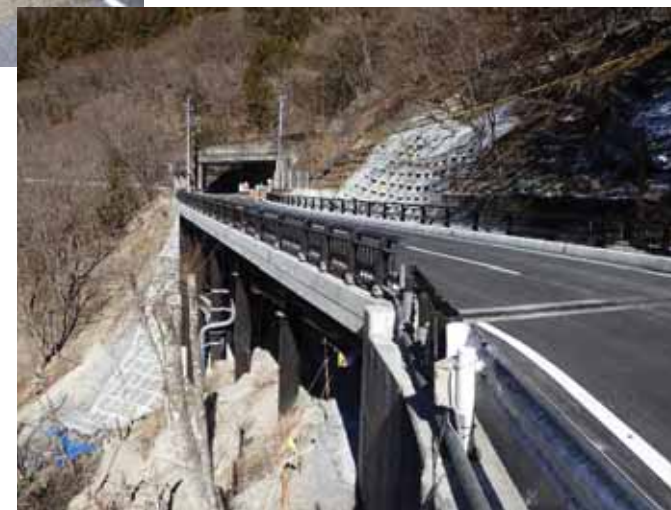
▲（主）南アルプス公園線（令和元年東日本台風災害）
