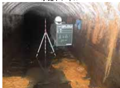
継ぎ目が開き土が漏れ出した状況
