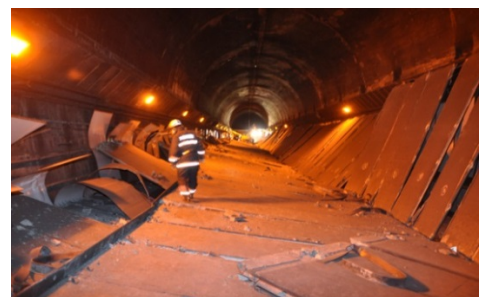
笹子トンネル天井板落下事故
