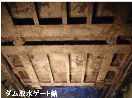
水門開閉装置の老朽化
