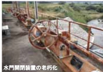
水門開閉装置の老朽化
