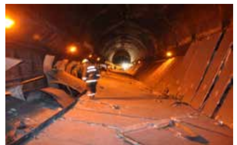
笹子トンネル天井板落下事故
