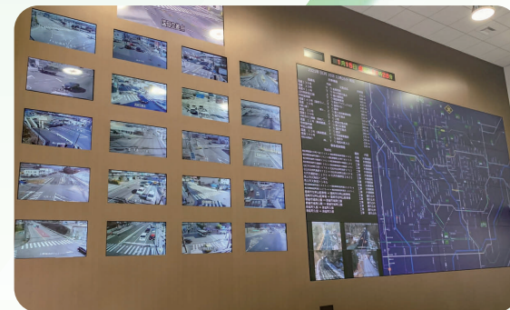
交通管制センター
