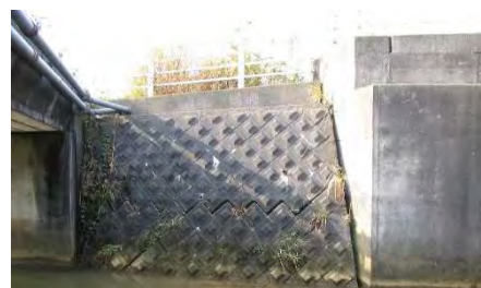
写真 2-2 橋台取付部（擁壁の目地開き）
