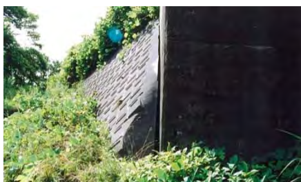
写真 2-1 橋台取付部（橋台と擁壁との隙間）
