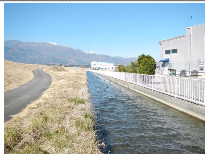
完成後 通水能力が向上したことから、維持管理労力が軽減されている。
