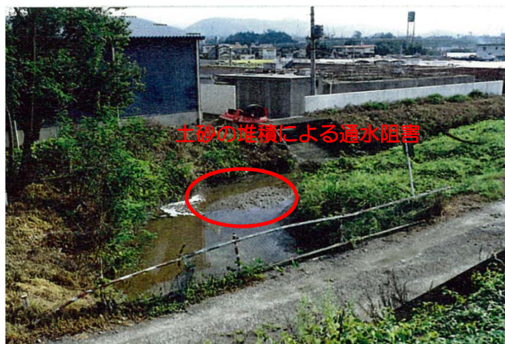
着工前 取水口から土砂が流入し通水阻害が生じていた。
