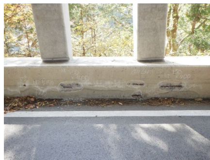
(4-2) 柱基部の剥離・鉄筋露出（健全性Ⅱ）
