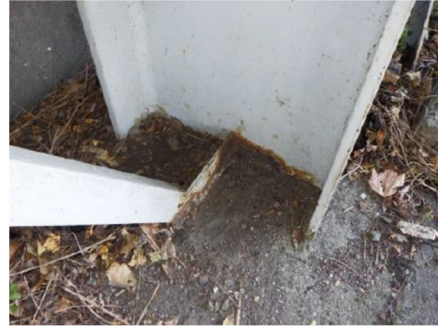
(2) 柱基部の腐食（健全性Ⅱ） 峡南第3ログシェッド：甲斐岩間停車場西島線
