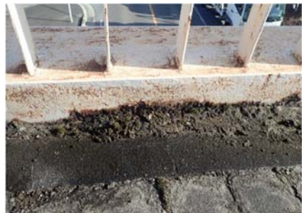
(3)志田歩道橋 腐食(健全性 )
