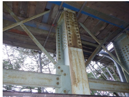
(3) 柱の腐食（健全性Ⅱ） 大沢洞門：富士川身延線
