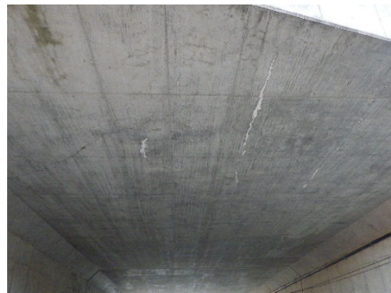
(4-2) 頂版のひびわれ、 遊離石灰（健全性Ⅱ）
