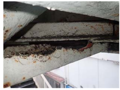
(3)志田歩道橋 腐食(健全性 )
