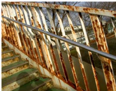
(1)東雲歩道橋 防食機能の劣化(健全性 )
