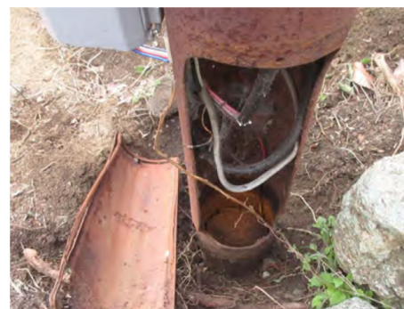
(4) 照明支柱開口部 (健全性Ⅲ)
