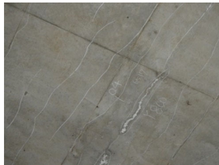
(2-2) 頂版のひびわれ（健全性Ⅲ） （曲げひびわれと推測される）
