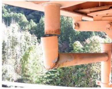
(2)三富小学校歩道橋 欠損(健全性 )
