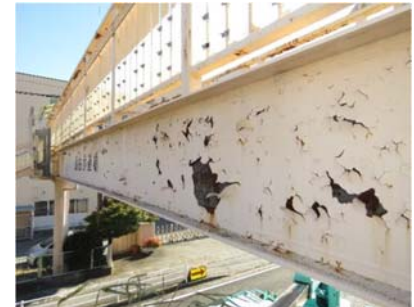
(3)落合歩道橋 防食機能の劣化(健全性 )
