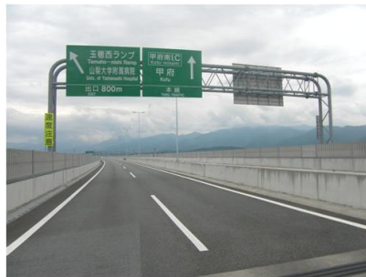
道路標識（門型柱）
