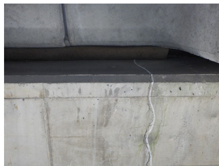
(2-2) 受け台のひびわれ（健全性Ⅱ）
