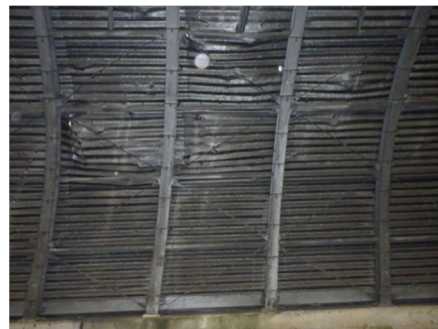
(6) デッキプレートの変形欠損（健全性Ⅱ） 下平スノーシェルター：韮崎増富線
