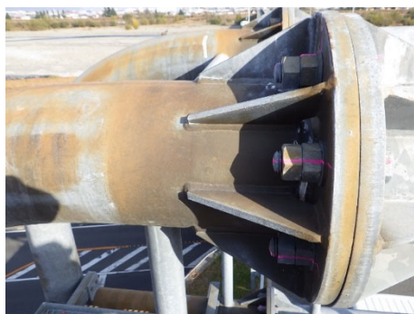
(3) 門型柱横梁 (健全度Ⅱ)
