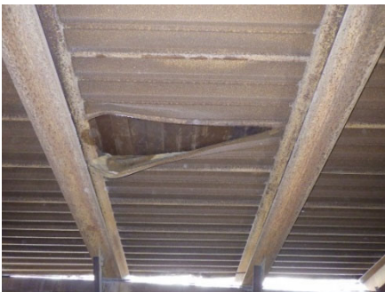
(5) 頂版の変形欠損（健全性Ⅲ） 無名洞門：南アルプス公園線
