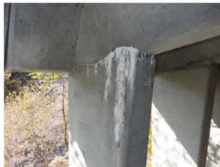
(3-2) 柱の遊離石灰（健全性Ⅱ）
