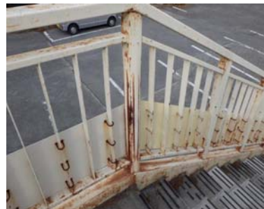
(2)田富歩道橋 き裂(健全性 )
