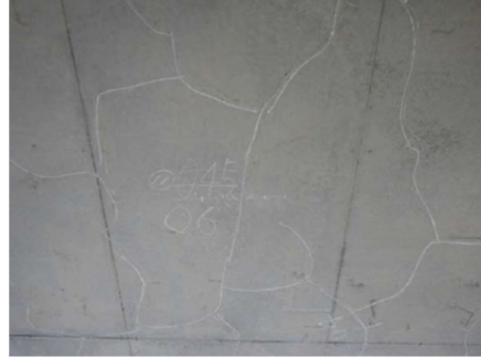
(1-2) 頂版のひびわれ（健全性Ⅱ）
