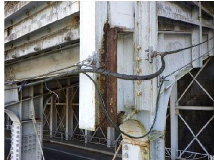
(4) 主梁の腐食（健全性Ⅱ） 峡南第3ログシェッド：甲斐岩間停車場西島線
