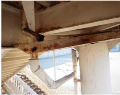
(1)田富歩道橋 腐食(健全性 )
