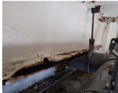
(2)武田歩道橋 腐食(健全性 )
