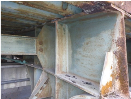
(3) 主梁の腐食（健全性Ⅱ） 大沢洞門：富士川身延線
