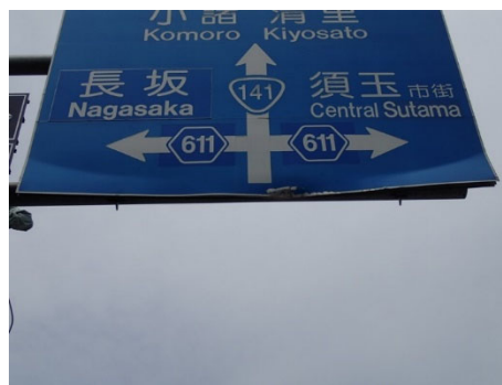
(2) 標識板 (健全性Ⅲ)
