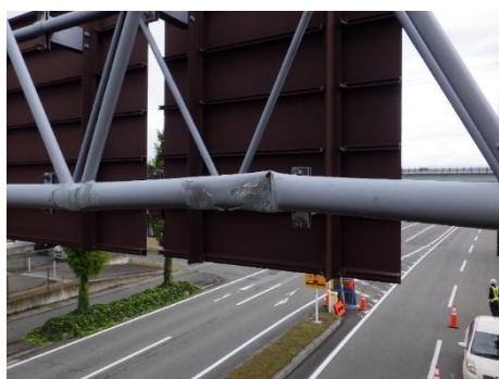
(1) 門型横梁 (健全性Ⅲ)
