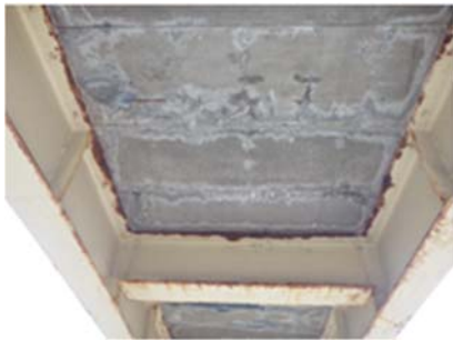
(1)北新歩道橋 防食機能の劣化(健全性 )
