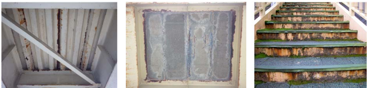
(1)田富歩道橋 防食機能の劣化(健全性 ) (2)北新歩道橋 剥離・鉄筋露出(健全性 ) (3)三富小学校前歩道橋 腐食(健全性 )
