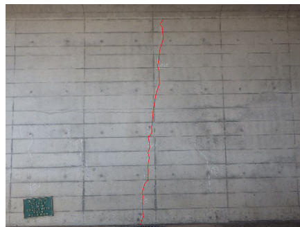
(1-1) 側壁のひびわれ（健全性Ⅱ）
