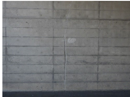
(3-2) 側壁のひびわれ（健全性Ⅱ）
