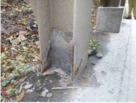
(1) 柱基部の腐食（健全性Ⅲ） 無名洞門：南アルプス公園線
