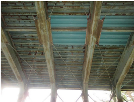
(3) 頂版の腐食（健全性Ⅱ） 大沢洞門：富士川身延線
