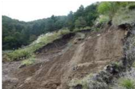
事業地内法面の崩れ
