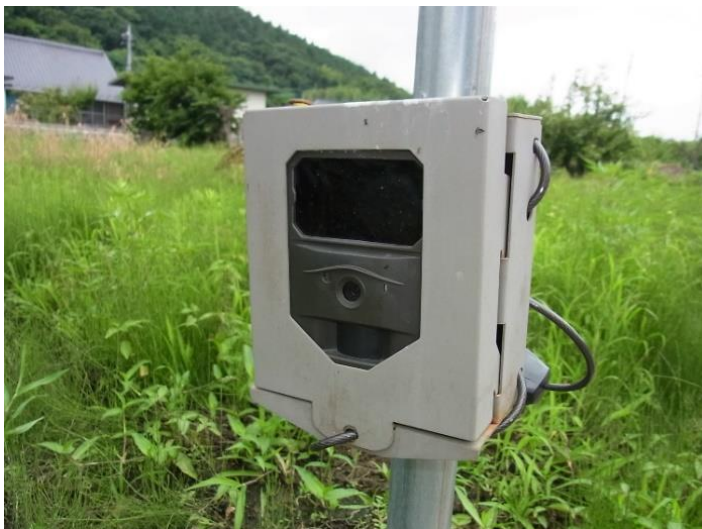
防犯カメラの設置
