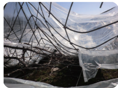
過去の大雪での被害（ハウスの倒壊）
