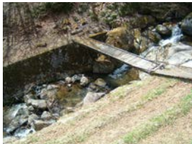
老朽化により通行不可の人道橋
