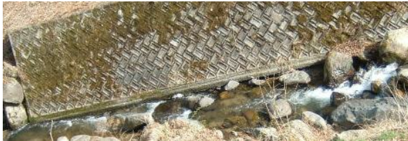
根入部が侵食された護岸
