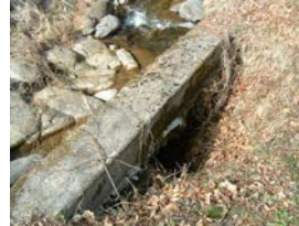
護岸背面が空洞化
