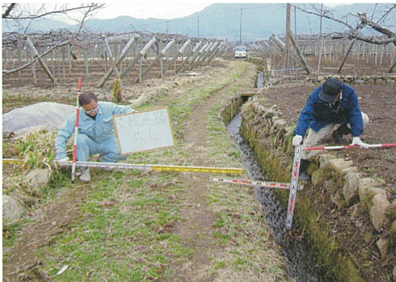
③着手前 未舗装で軽トラックがぎりぎりの幅員しかなく、農作業の大きな障害となっていた。
