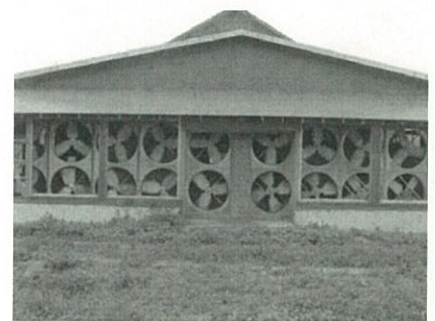
牛舎壁面の換気扇
