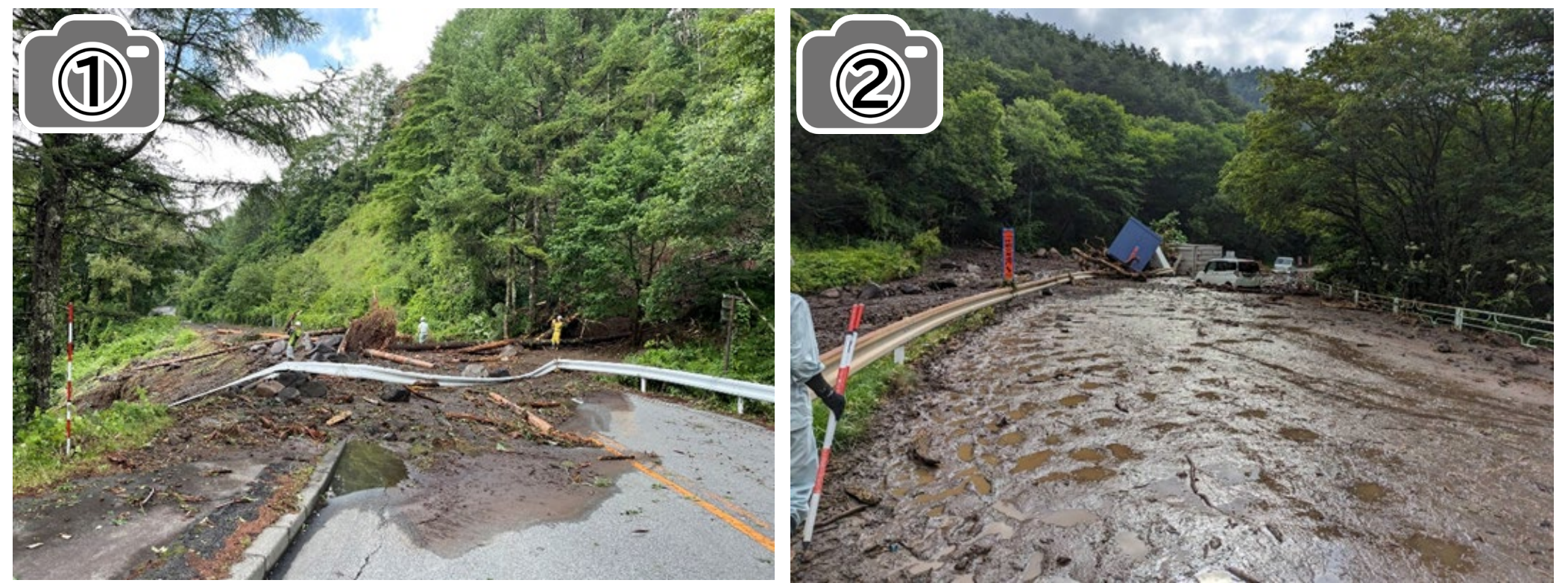
主要地方道北杜富士見線(山梨県北杜市大泉町谷戸地内)土砂流出 令和5年7月20日 土砂流出により延長約9.3kmにわたり全面通行規制を実施
