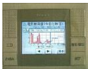
エネルギー管理システム
