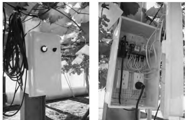
図3 タイマー機能付き電源の外観と内部の様子
