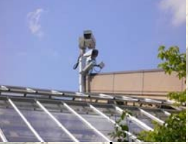
河口湖監視カメラ(改築)
