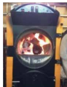
温泉施設の薪ボイラーで利用
