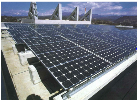
発電総合制御所(クリーンエネルギーセンター)太陽光発電施設(山梨県企業局)
