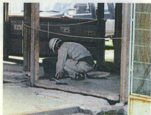
欠損箇所 工事
