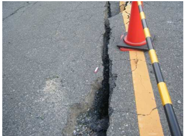
西原村 地割れの状況
