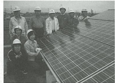
山梨県で2番目の発電所「山城ひまわり第1発電所」設置工事の様子
