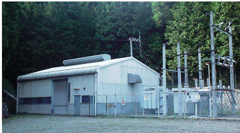
琴川第一発電所
