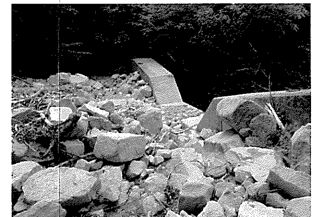
② H14既設満砂状況
