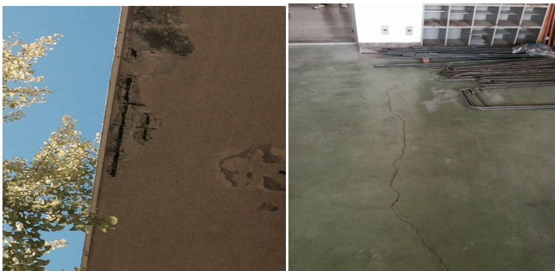
図 I - 8 峡南高校の天井鉄筋の露出（左）と教室床のひび割れ（右）
