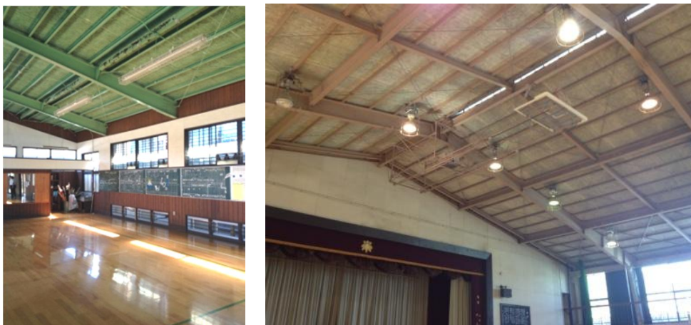
図Ⅱ－34 市川高校の体育館の天井吊り材
