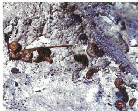
住宅の基礎部分に見られたヤケヤスデの死骸
