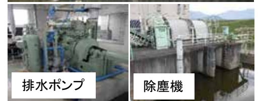
農業用施設の長寿命化（排水機場）
