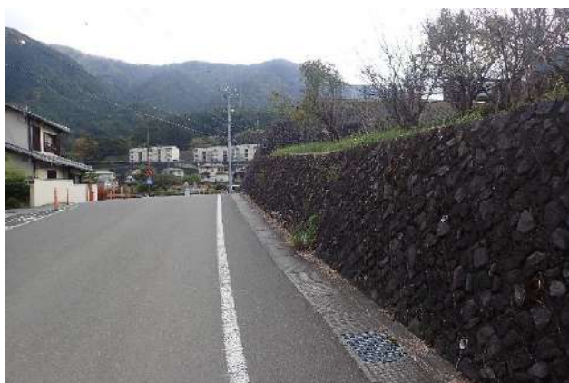
写真 8.1.8-16 住宅地（西桂町） 舗装・石垣
