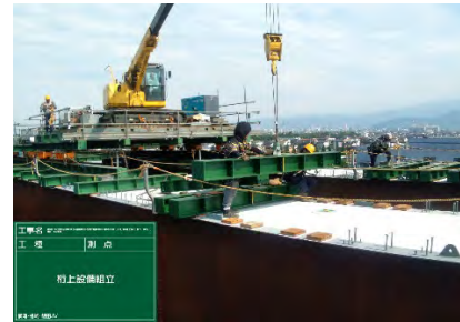
桁上軌条設備
