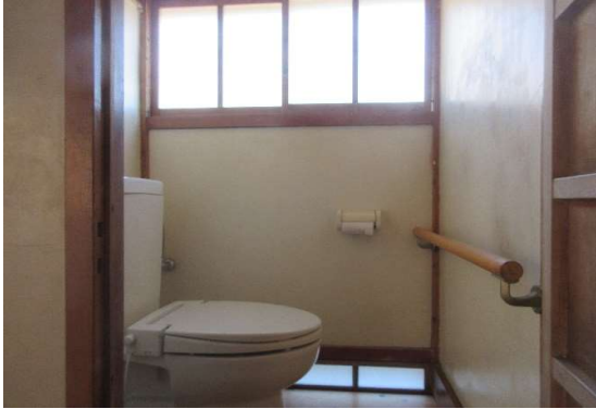
トイレ(大便器)
