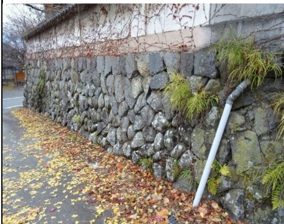
雨水は配管処理。一部盛土ではないか。
