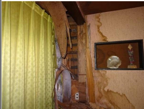
雨染み、壁・天井板の剥がれ
