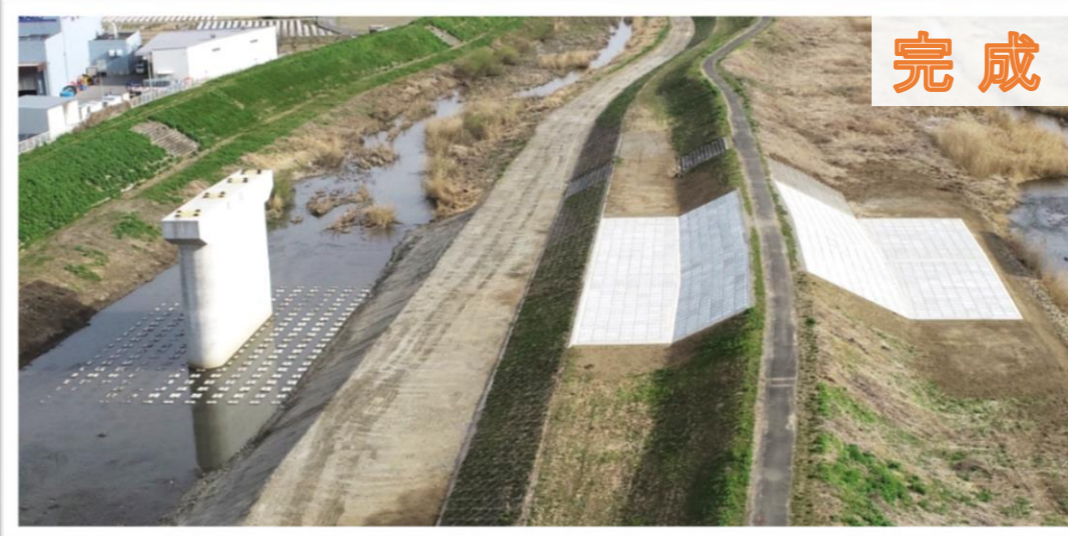
流水による影響から 河岸や川の底を守る為の工事を行いました。
