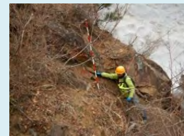
落石重点箇所
