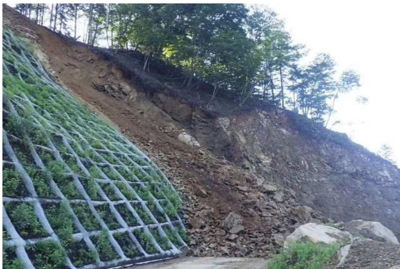
令和2年8月26日降雨による崩落
