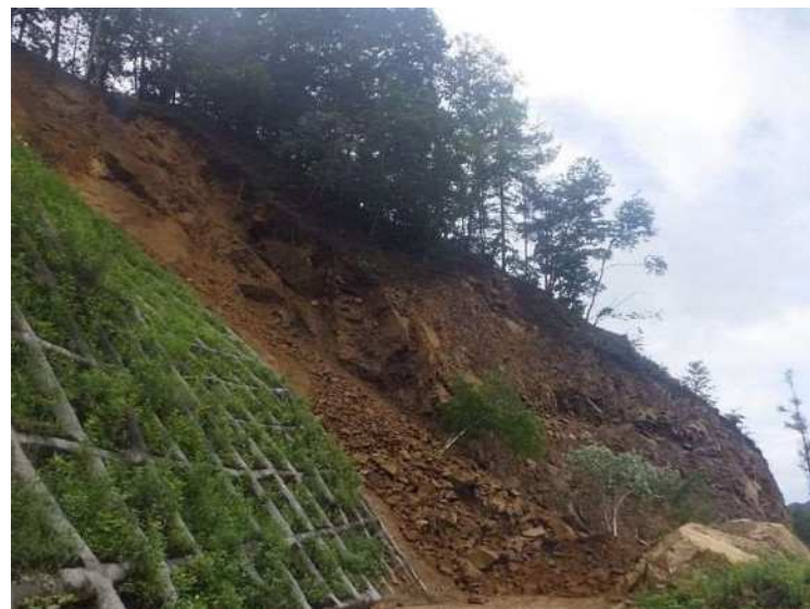
令和2年9月8日降雨による崩落
