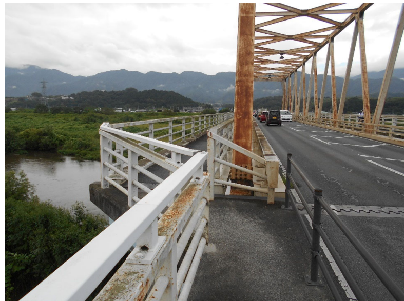
【写真①】 歩道線形が悪く見通しが悪い状況
